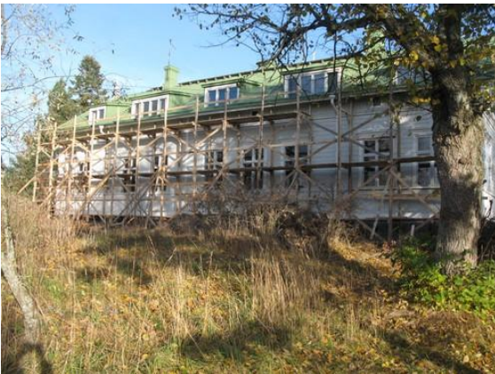
Kuvateksti: Päärakennus tieltä päin. Kattoikkunoiden uusiminen käynnissä. Kuvajaji: yleiskuva Kuvaaja: Nummelin Liisa Kuvausaika: 22.10.2010
