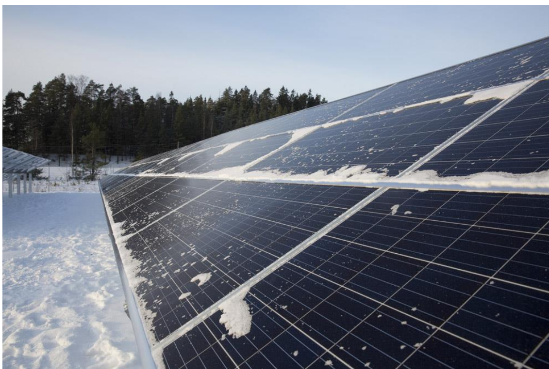
Kuva 2-12 Aurinkopaneeleja lumisissa olosuhteissa. (Kuva: Keravan Energia)
