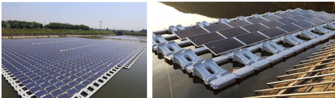
Kuva 2-8 Esimerkkejä kelluville perustuksille asennetuista aurinkopaneeleista. (Kuvat: Ciel&Terre)
